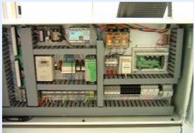
Compartimiento Eléctrico para proceso automático
